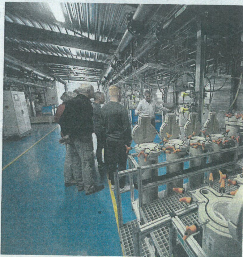
Een kijkje in het hart van de proefinstallatie op de Afsluitdijk, in 2021.
